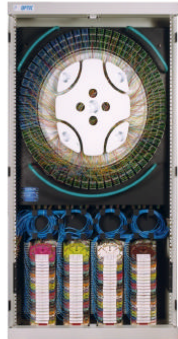
Répartiteur 1000 fibres en armoire double ETSI
